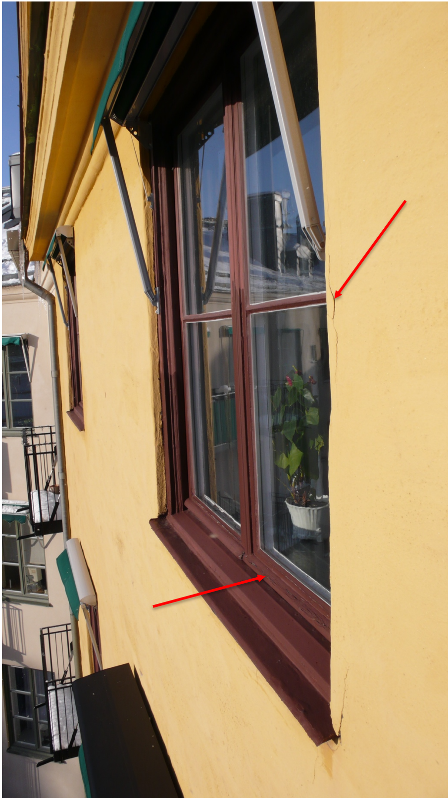
Bild 5. Flagnande färg och ytliga rötskador konstaterades, företrädesvis i nederdelar av fönsterpartier. Notera även putssprickan i fönstersmygen, rasrisk föreligger.
