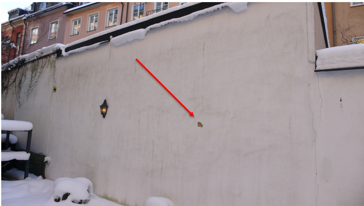
Bild 3. Lös och bom puts konstaterades i gårdsmur. Ytskikt flaggar av.
