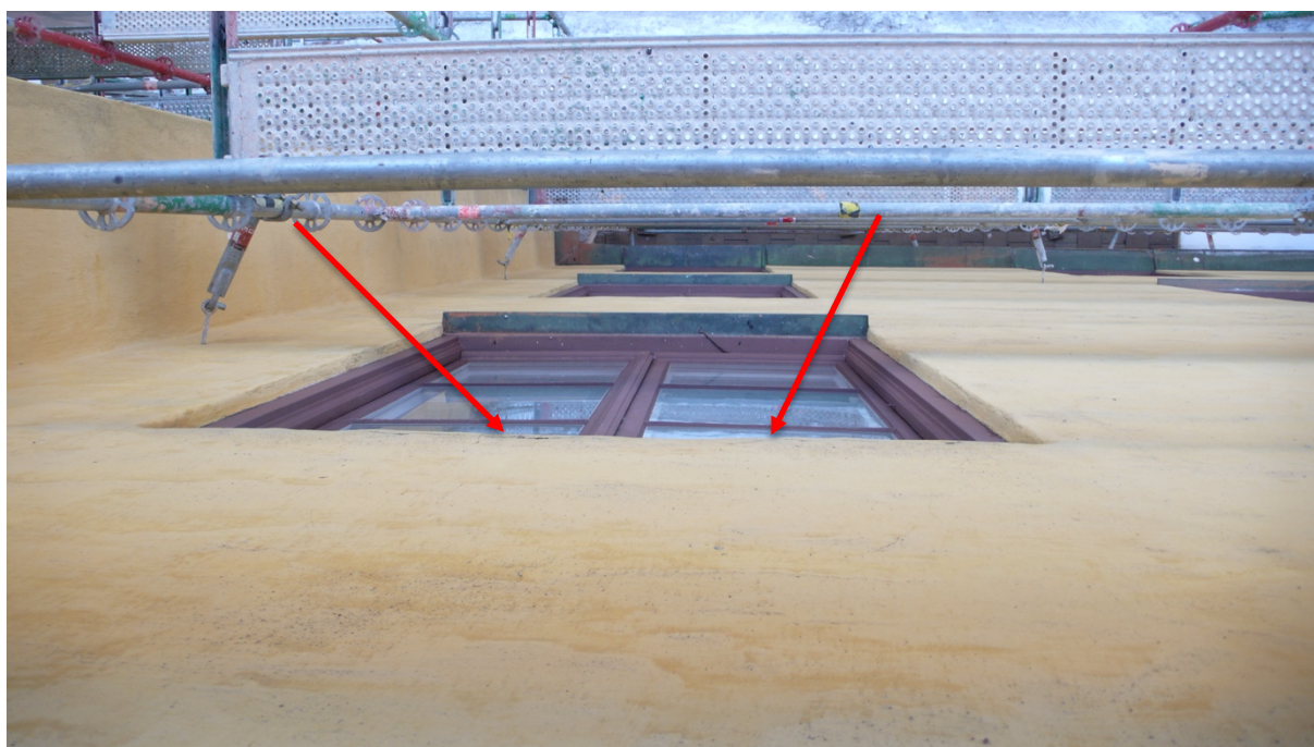
Bild 2. Lös och bom puts med risk för ras konstaterades i flera fönstersmygar.
