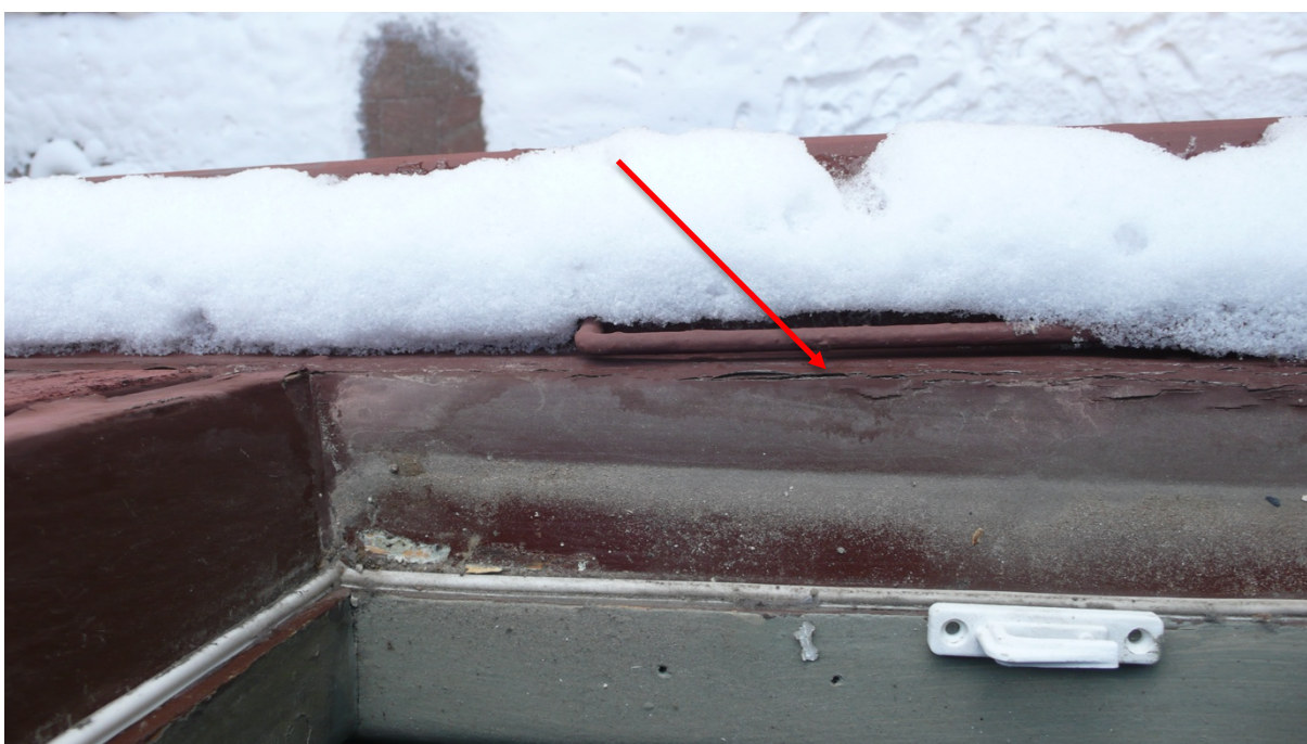
Bild 4. Flagnande färg och ytliga rötskador konstaterades, företrädesvis i nederdelar av fönsterpartier.
