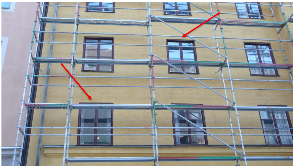
Bild 1. Lös och bom puts med risk för ras konstaterades i flera fönstersmygar.
